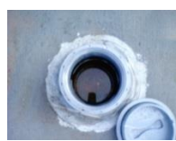
水が溜った状態
